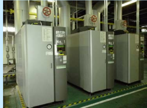
貫流ボイラ外観
