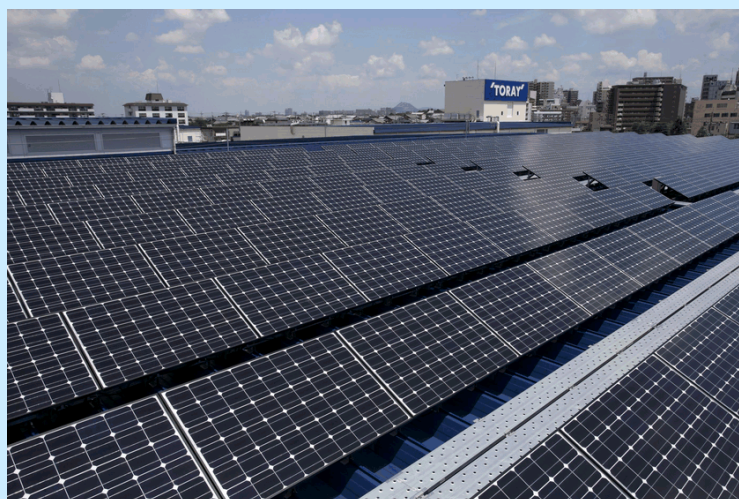
太陽光発電実証設備と後方はLED看板
